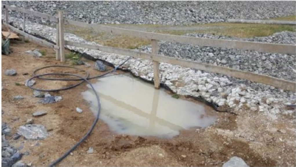
Figura 67 - Falta de sistema de drenagem superficial
