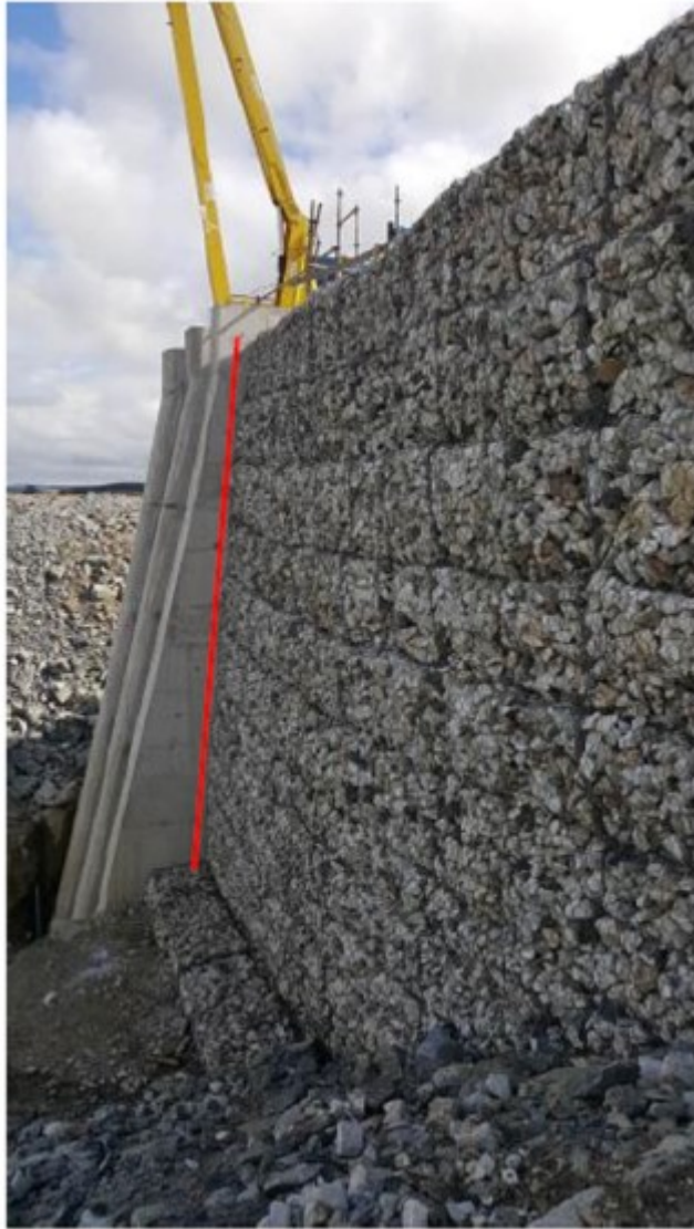
Figura 57 - Alinhamento subvertical da estrutura
