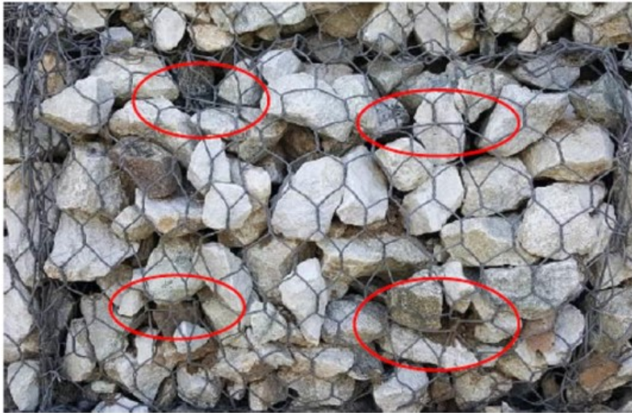
Figura 62 - Tirantes tensionados excessivamente e distribuídos de forma irregular
