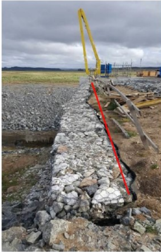
Figura 55 - Desalinhamento da crista do muro
