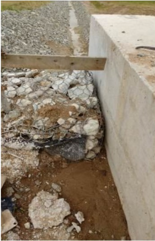
Figura 65 - Ausência de caixa lateral
