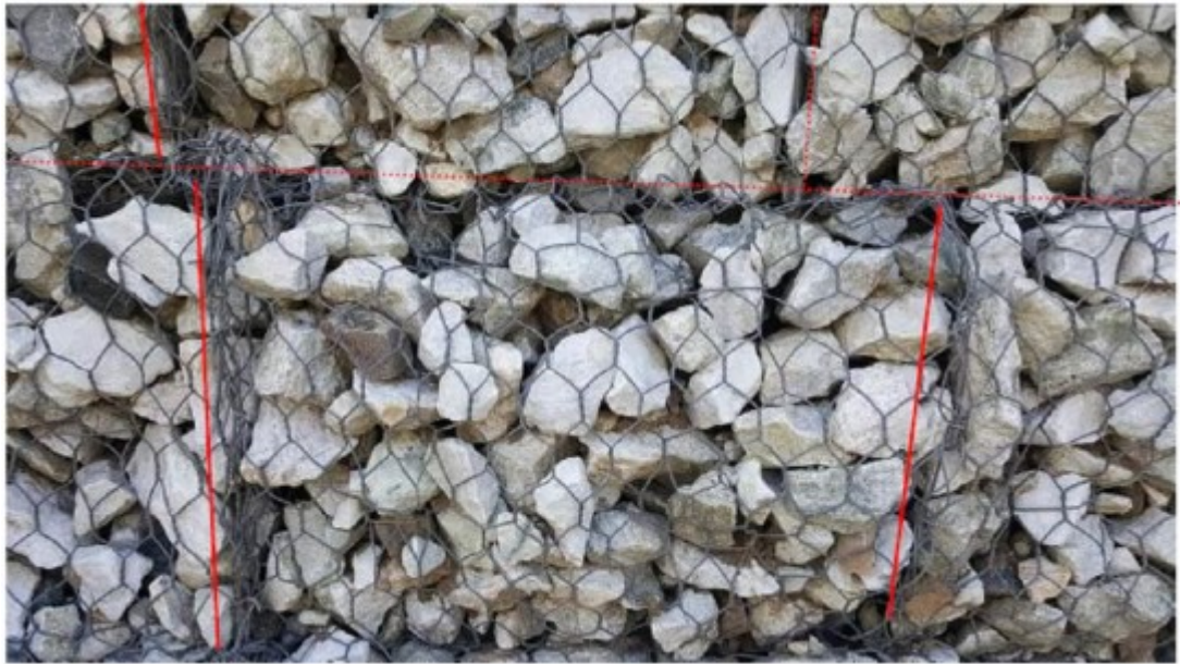
Figura 64 - Falta da costura entre as caixas superiores e inferiores
