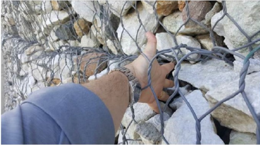
Figura 60 - Vazios dentro da caixa do sistema Terramesh
