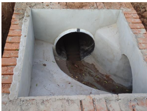
Figura 5 - Caixa de passagem
