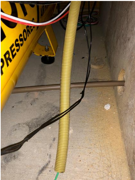
Figura 17 – Tubulação de PVC 25mm conectada ao dreno automático na clínica Odontocompany de Florianópolis
