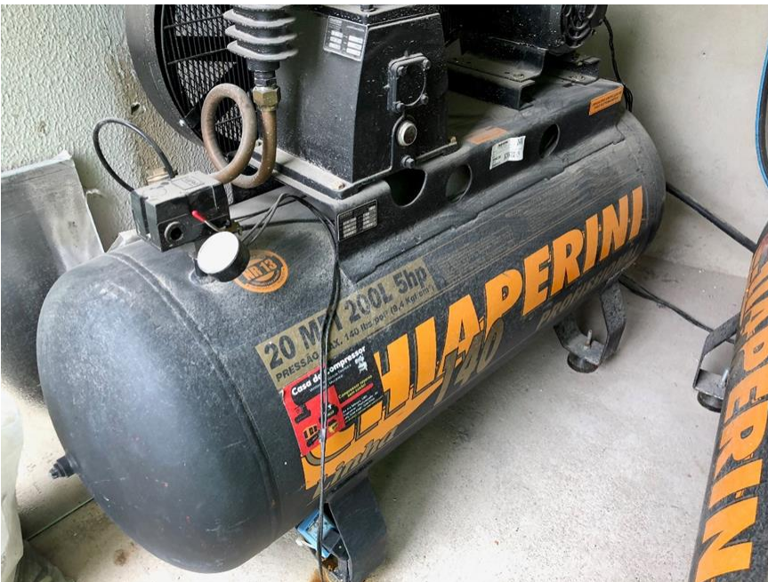
Figura 14 - Compressor Chiaperini 200L instalado pela Casa do Compressor na clínica Odontocompany de Palhoça
