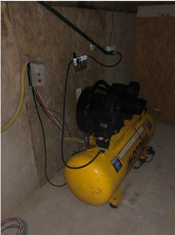
Figura 16 – Compressor corretamente instalado na clínica Odontocompany Florianópolis
