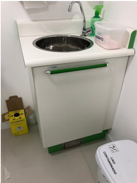
Figura 34 - Lavatório com acionamento por pedal instalado da clínica Odontocompany de Palhoça
