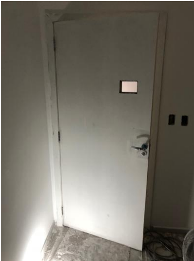
Figura 26 – Porta com lâmina de chumbo de 1,5mm de espessura da sala de Raio-X Panorâmico da clínica Odontocompany de Florianópolis
