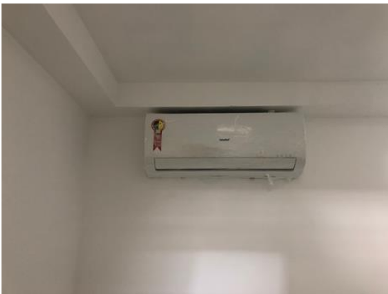
Figura 27 – Aparelho de ar condicionado de 9000BTUs para climatização da sala de Raio-X Panorâmico da clínica Odontocompany de Florianópolis
