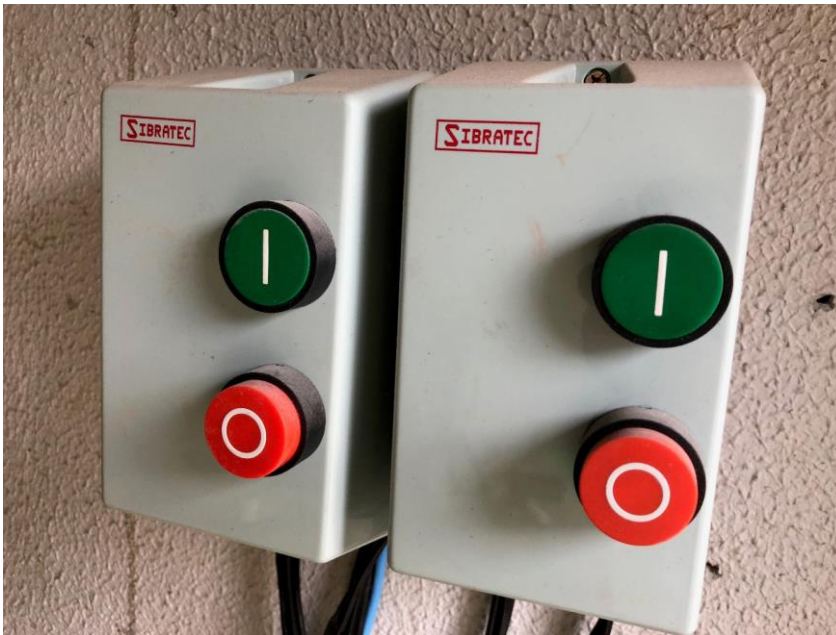
Figura 13 - Chaves Contactoras instaladas pela Casa do Compressor na clínica Odontocompany de Palhoça
