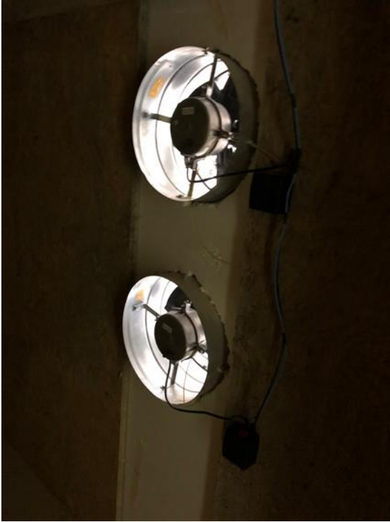
Figura 15 - Ventiladores para insuflamento e exaustão de ar no abrigo dos compressores
