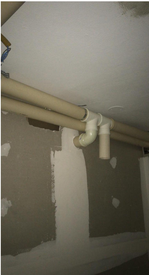
Figura 28 - Sistema de exaustão e insuflamento dos banheiros sem ventilação natural da clínica Odontocompany de Palhoça
