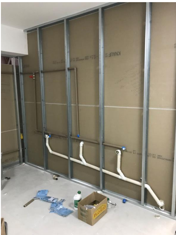
Figura 31 - Infraestrutura hidrossanitária dos lavatórios da clínica Odontocompany de Florianópolis
