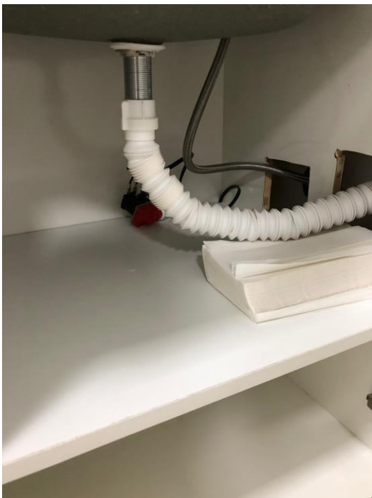
Figura 35 - Bomba de acionamento, flexível e sifão do lavatório da clínica Odontocompany de Palhoça
