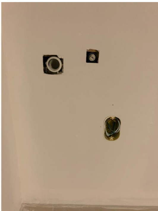
Figura 33 - Ponto de esgoto, água fria e alimentação elétrica para os lavatórios da clínica Odontocompany de Florianópolis
