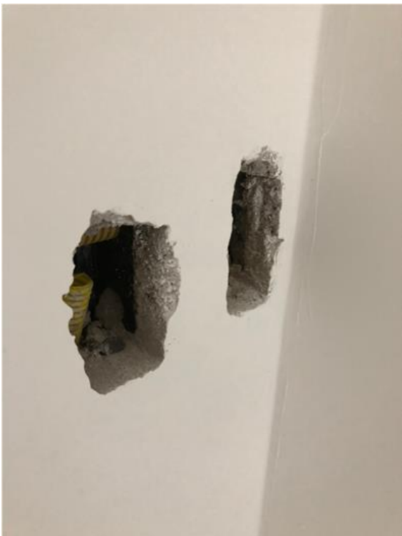
Figura 25 – Visível a espessura da barita nas caixas de luz da sala de Raio-X Panorâmico da clínica Odontocompany de Florianópolis.
