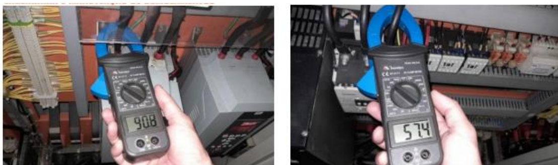
Figura 3 – Medições nas cabines de comando, utilizando multímetro (Bombas e CCM).
