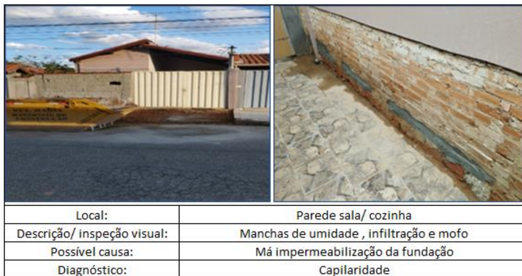
Figura 11: Manifestações patológicas encontradas da residência 6.
