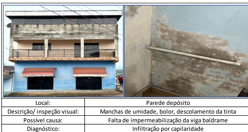
Figura 6: Manifestações patológicas encontradas na residência 1.
