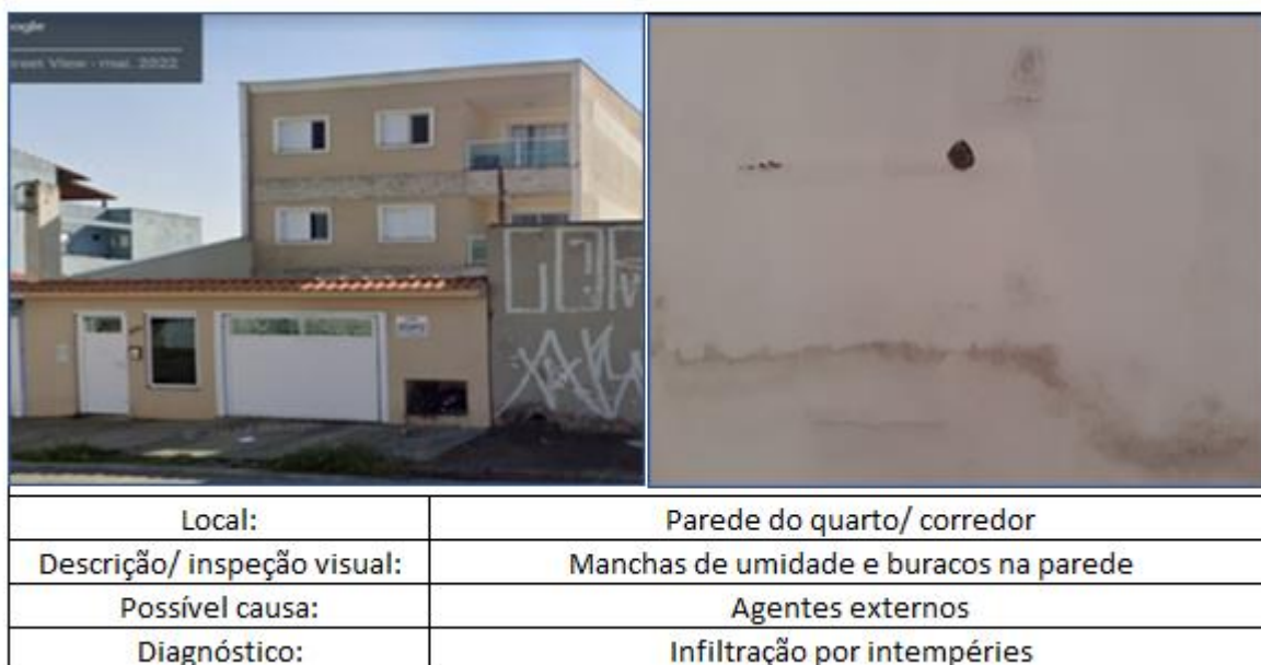
Figura 10: Manifestações patológicas encontradas da residência 5.
