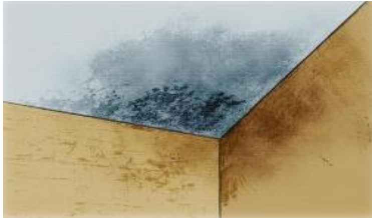
Figura 2: Infiltração por intempéries
