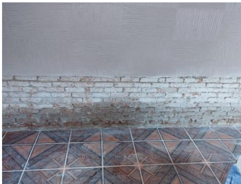
Figura 14: Umidade por capilaridade.
