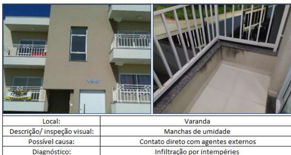
Figura 12: Manifestações patológicas encontradas da residência 7.
