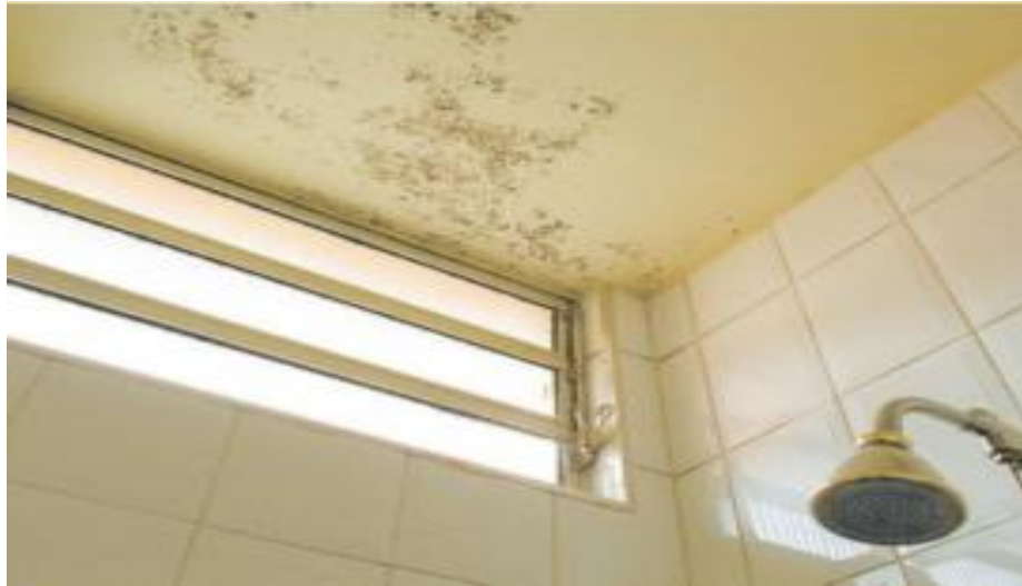
Figura 3: Infiltração por condensação
