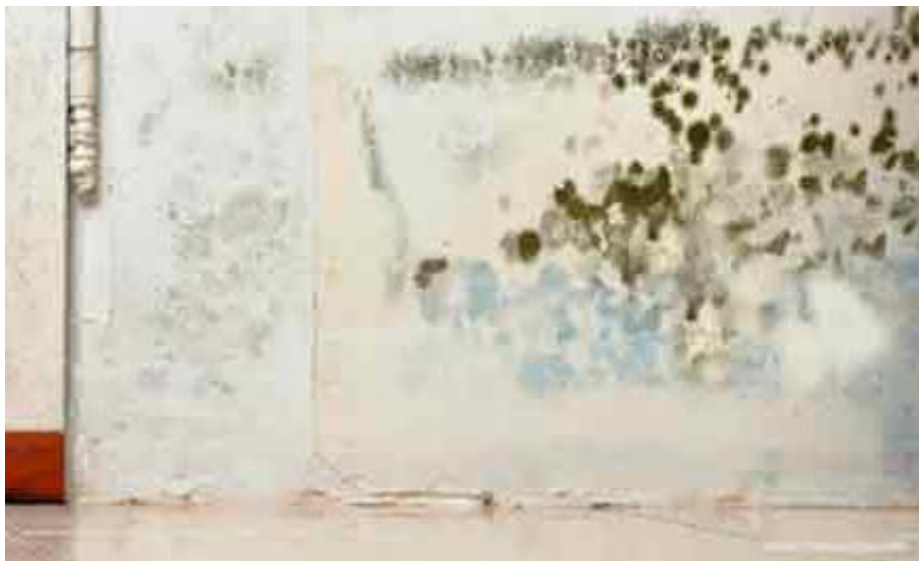
Figura 4: Infiltração por capilaridade
