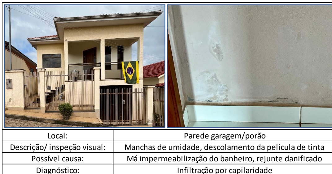
Figura 9: Manifestações patológicas encontradas na residência 4.
